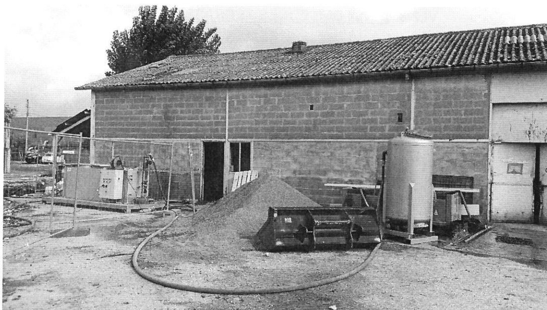
Figure 10 : Système de pompage et traitement de l'eau
