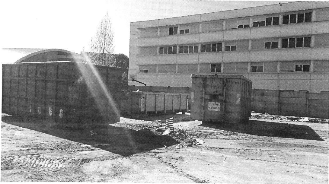
Figure 7 : Stockage des déchets en bennes
